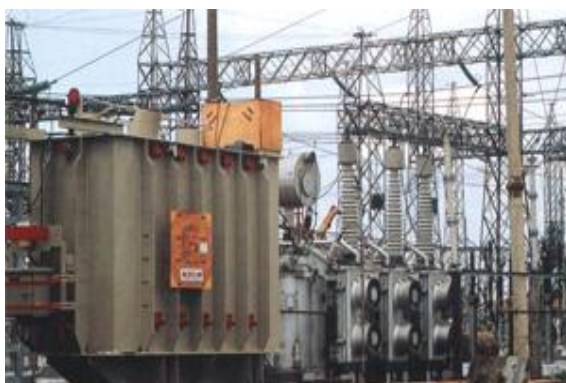
Trạm biến áp 500 KV
